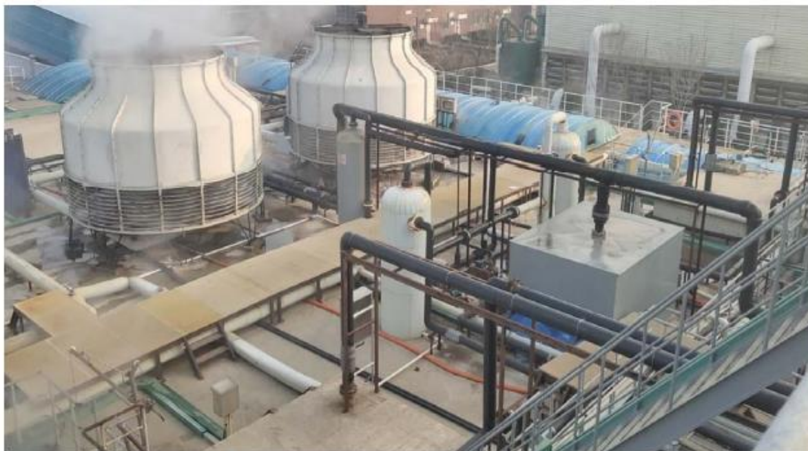
Figure B - 2 渗滤液处理站
